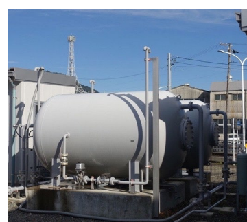
ガス貯蔵タンク
